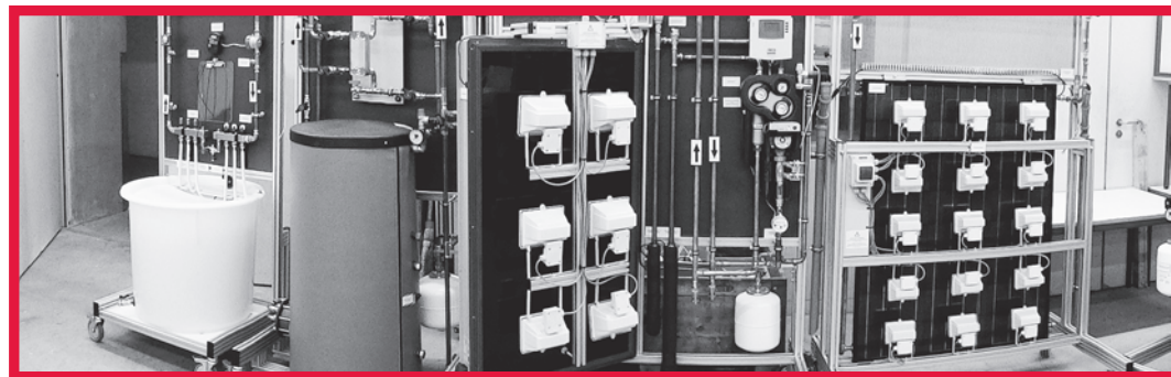
Schulungsanlage im Solarteurlabor.
