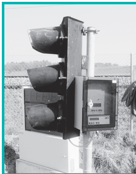
Ampel mit Steuerungskasten.
