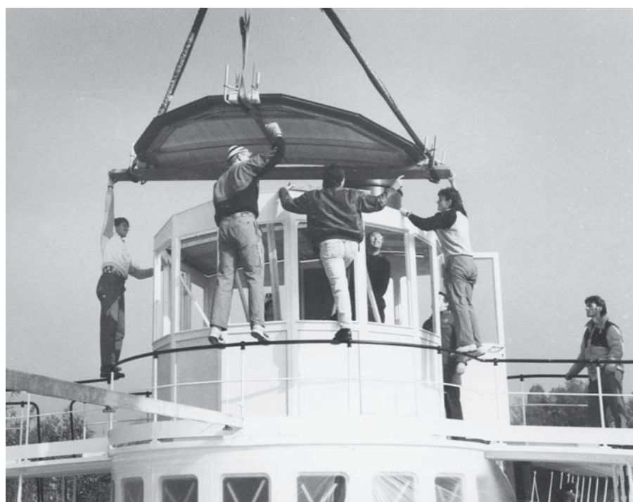
➤ Aufsetzen des Falzdachs auf das Steuerhaus des restaurierten Dampfschiffes Blümlisalp im Oktober 1991. Ausgeführt durch die Spengler- und die Innenausbauabteilung.
